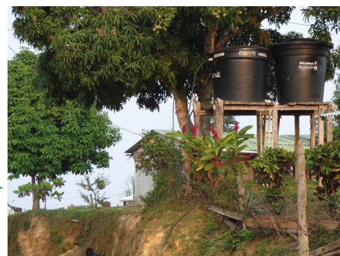
Abasto de agua vereda La Cristalina
