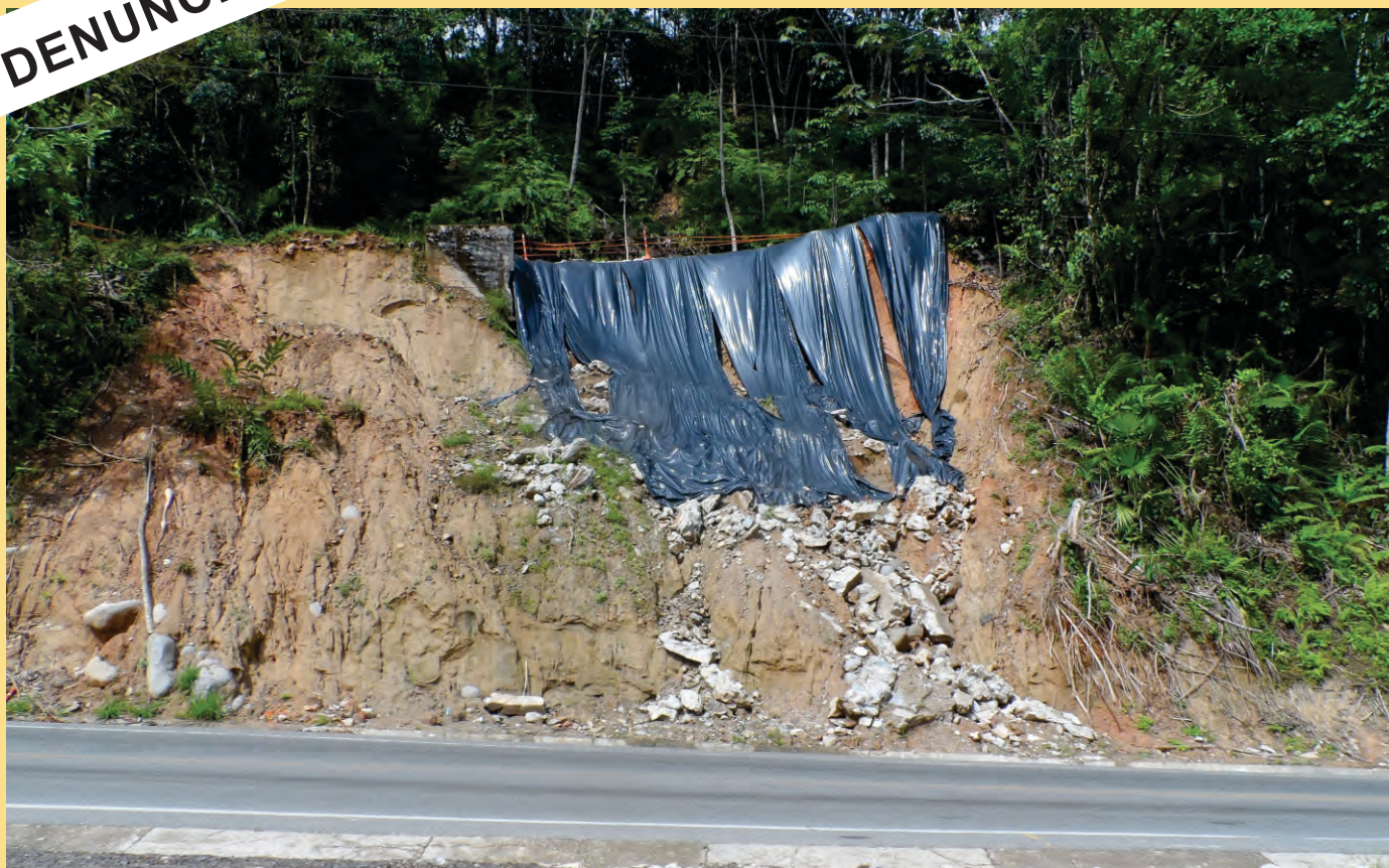
Pérdida de la banca en el cruce
