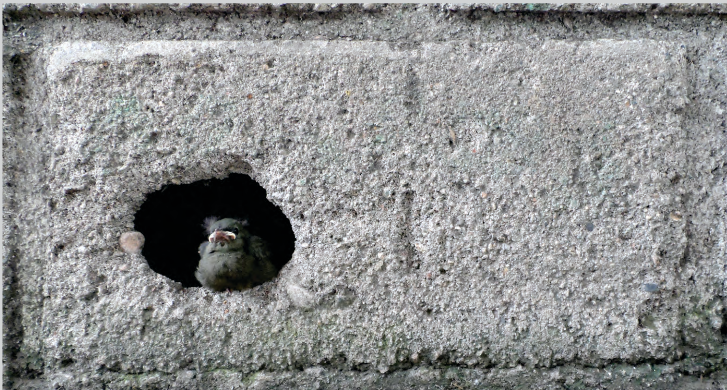
Nido de concreto
